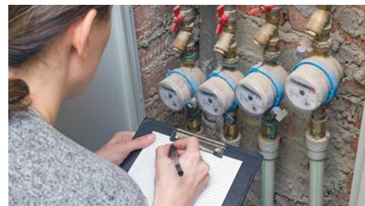
Ilustración 11 - La Comunidad de Madrid ha atendido un total de 940 incidencias por congelación de contadores desde la llegada de la borrasca Filomena a la región. [43]
